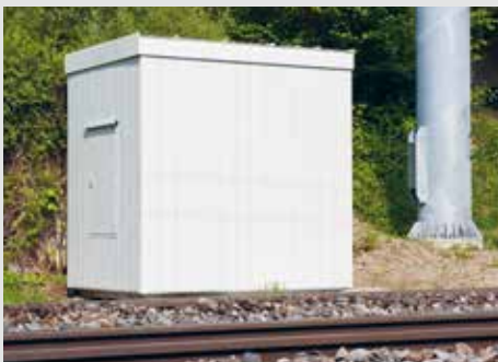
Kabine zum Schutz für mobile Funknetze und Kontrollsysteme.
